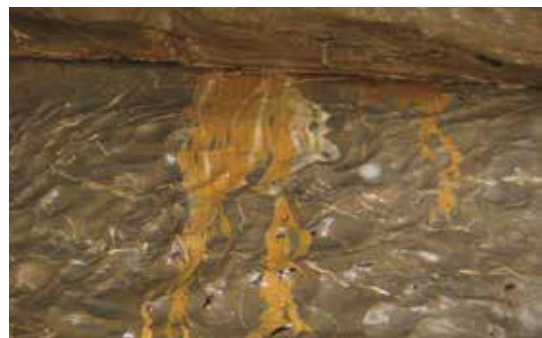
Wandsinter aus Schichtfuge
