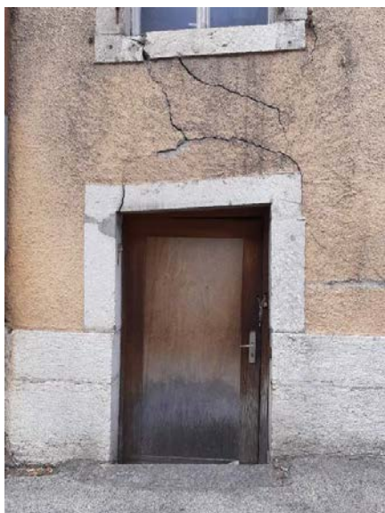
Le centre-ville du Locle est construit sur de la tourbe dont le drainage induit des tassements endommageant les bâtiments.
